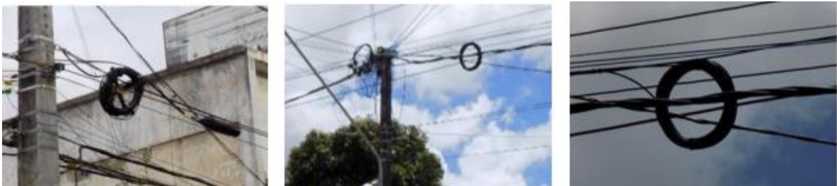
Figura 02. Instalações irregulares de reversas técnicas tipo cruzeta
